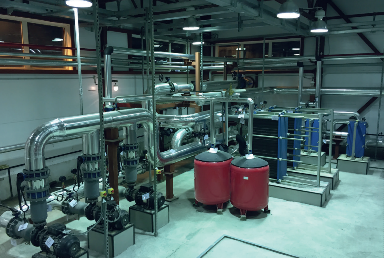
Котельная, г. Апатиты
